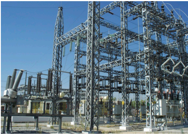
Figura No.2 Subestación Eléctrica
