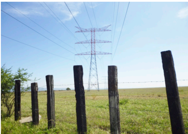
Figura No.3 Línea de Transmisión
